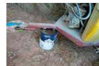
Dispositivo di supporto non adeguato
